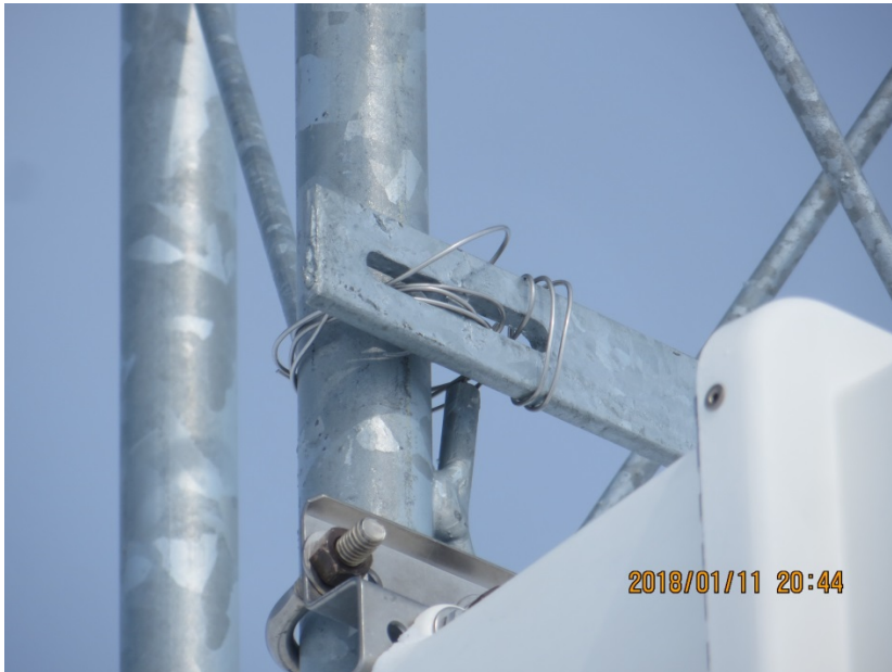
Wire on antenna mount.
